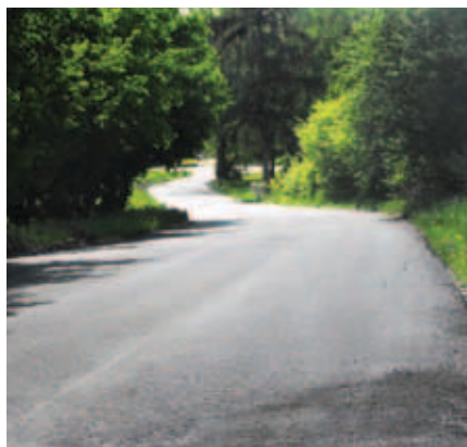
Ułożenie nawierzchni bitumicznej na ul. Reymonta w Krzczonowie wraz z remontem przyczółka przepustu i założenie bariery energochłonnej na przepuscie
