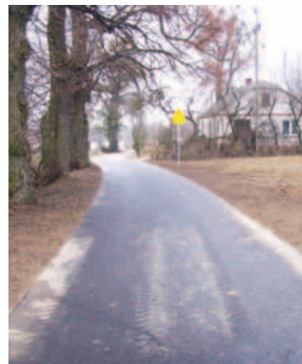
Odbudowa drogi gminnej nr 112492L od km 0+005 do km 0+245 w miejscowości Krzczonów, ul. Lipowa (240 m)
