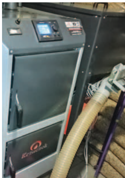
Kocioł na biomasę – „Energia ze źródeł odnawialnych”
